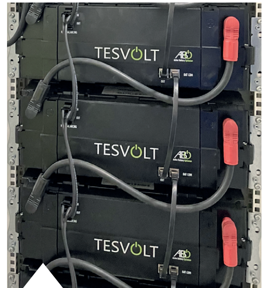
Batteries de stockage
