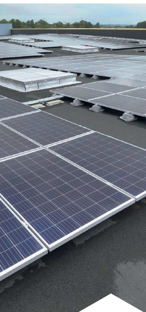
Centrale de Strasbourg
